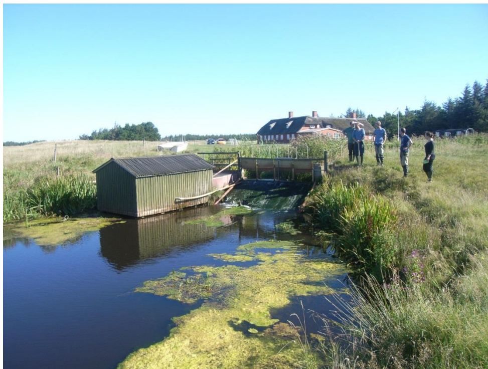
Figur 5.1.5.1: "Hullet" som er fremkommet gennem erosion nedstrøms stemmeværket. Hullet opfyldes delvist over til ålekisten og stemmepladerne sænkes helt.
